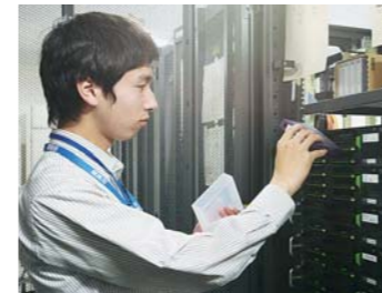
システムのバックアップカセットを交換している様子。医療情報データが厳重に管理されています。
