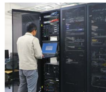
自社サーバ室。
