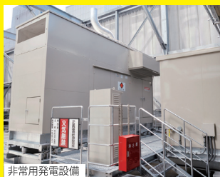
非常用発電設備
