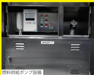
燃料供給ポンプ設備
