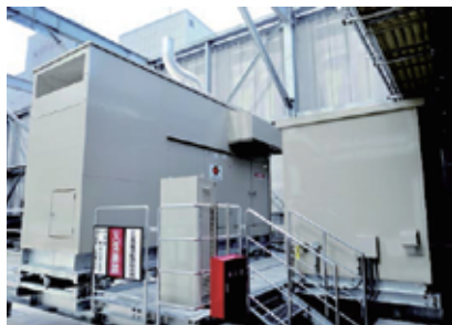
写真5: 非常用発電機
