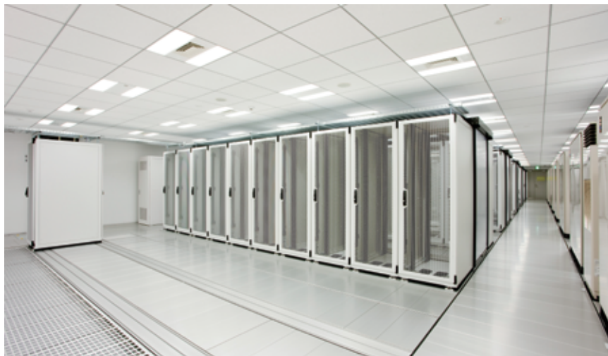
写真1：TOHKnet「仙台中央データセンター」
