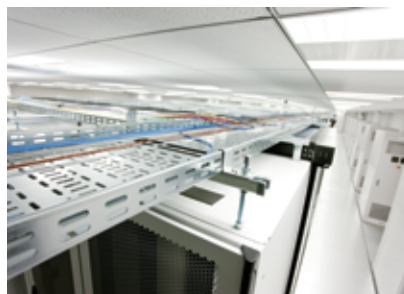
写真8: ケーブルラダー
